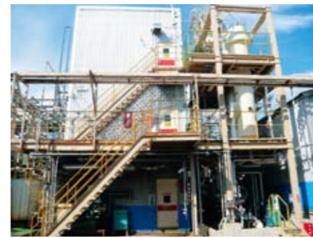
光氣生產設備外觀
